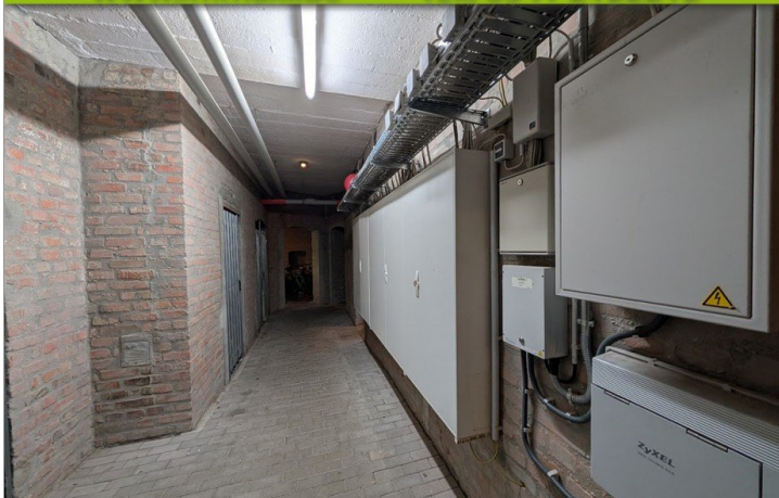
Keller mit Anschlüssen
